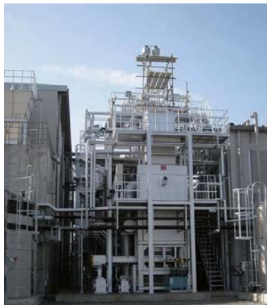
バイオマスボイラー設備
