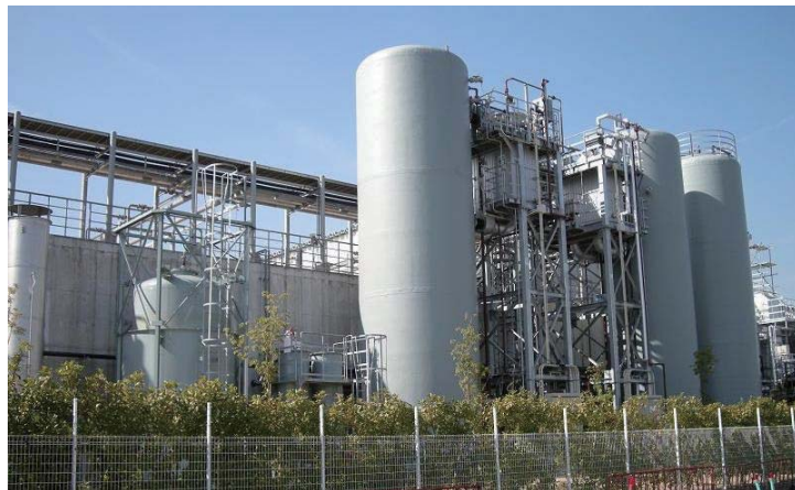
メタン発酵設備
