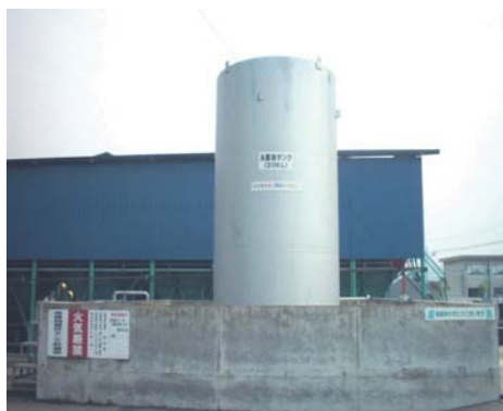
再生油タンク設備
