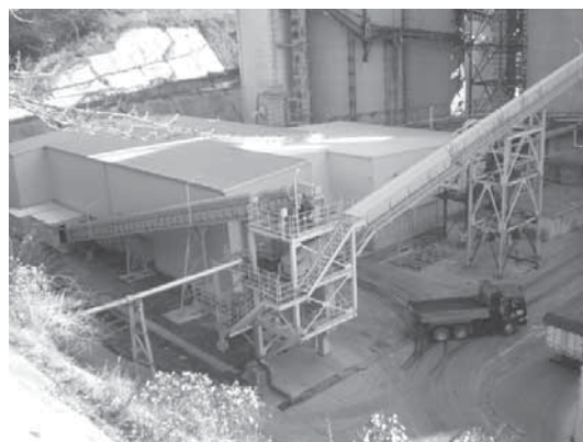
写真③ 不法投棄廃棄物受入用に設置した施設
