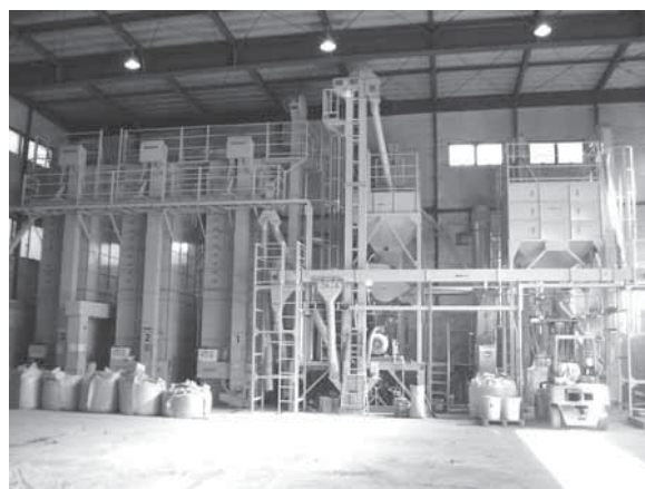
木質ペレット製造プラント
