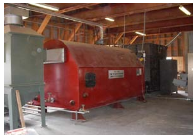
「木質資源利用ボイラー」
